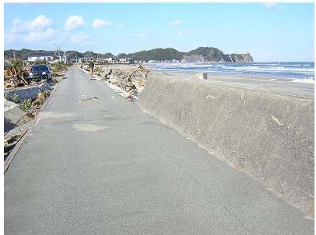
なんと・・・コンクリートの堤防提が津波により破壊されました。
